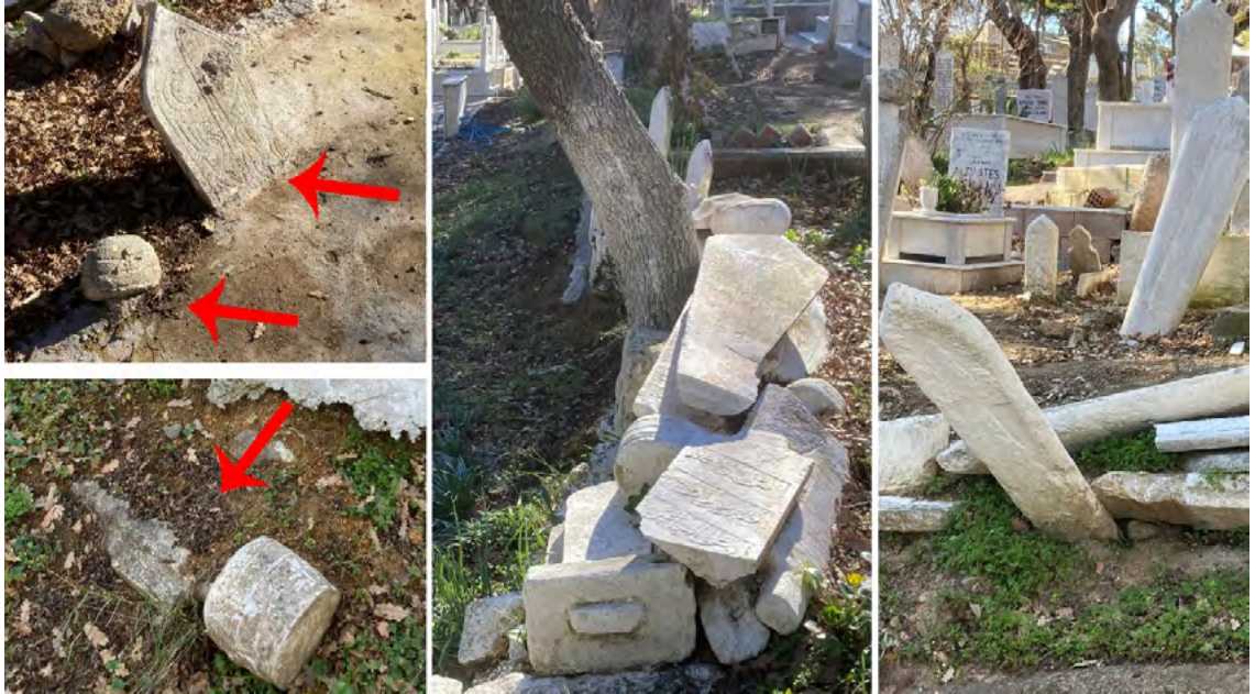
Fot. 2: Doğançay (Alurca) Köyü mezarlık alanı içinde taşların maruz kaldıkları güncel olumsuz durumlar. (E. Özbay 2022)
